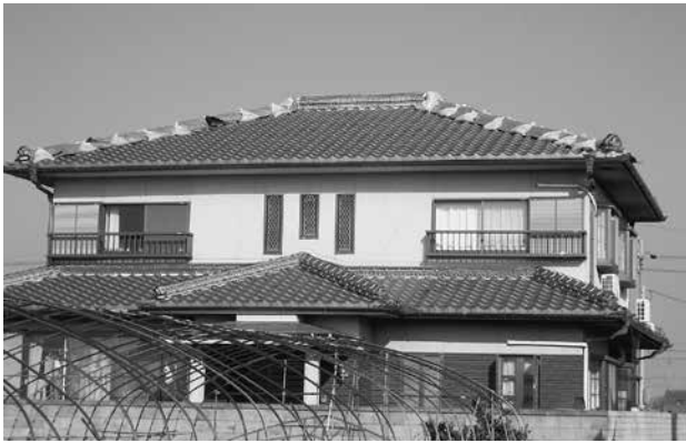
被災して修理を待つ住居
