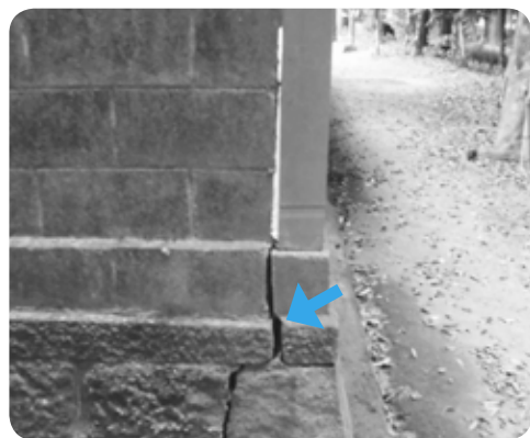
地震被害で亀裂が生じたブロック塀(雙栗神社)
