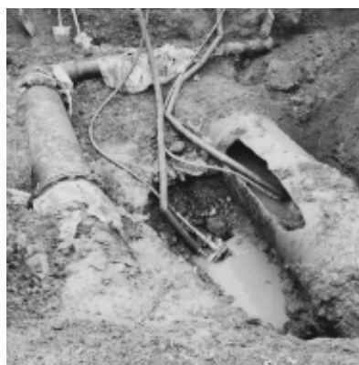
老朽水道管破裂事故(大阪北部地震)
