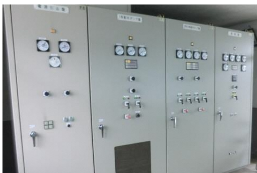
写真 2.8 佐古浄水場ポンプ制御盤
