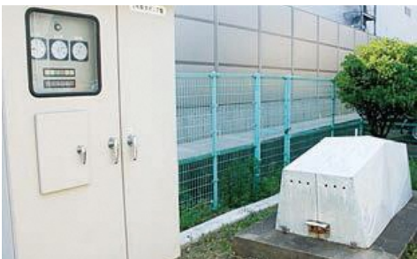
写真 2.2 取水井と取水ポンプ盤
