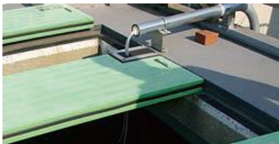
写真 2.3 着水井と塩素注入器
