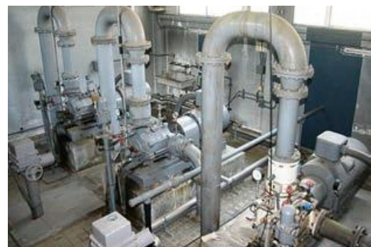
写真 2.7 佐古浄水場配水ポンプ
