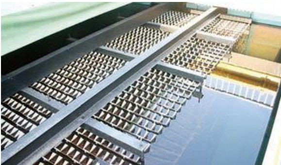
写真 2.4 傾斜板沈澱池
