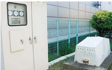
写真 2.2 取水井と取水ポンプ盤
