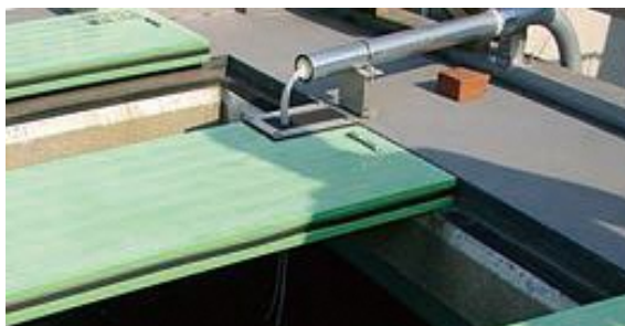
写真 2.3 着水井と塩素注入器
