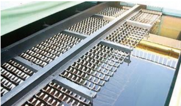
写真 2.4 傾斜板沈澱池
