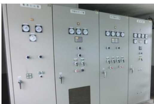
写真 2.8 佐古浄水場ポンプ制御盤
