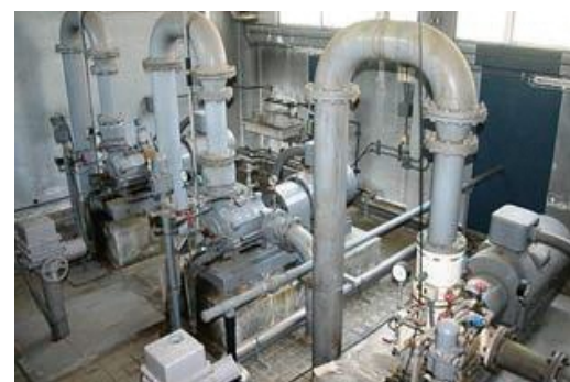
写真 2.7 佐古浄水場配水ポンプ
