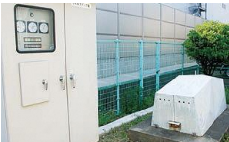
写真 2.2 取水井と取水ポンプ盤
