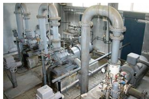
写真 2.7 佐古浄水場配水ポンプ
