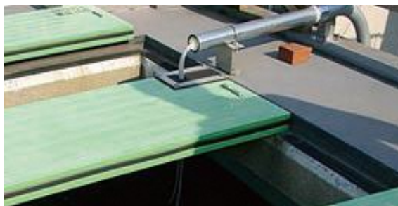
写真 2.3 着水井と塩素注入器
