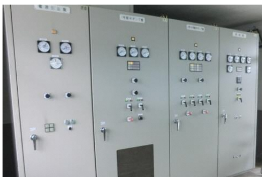
写真 2.8 佐古浄水場ポンプ制御盤
