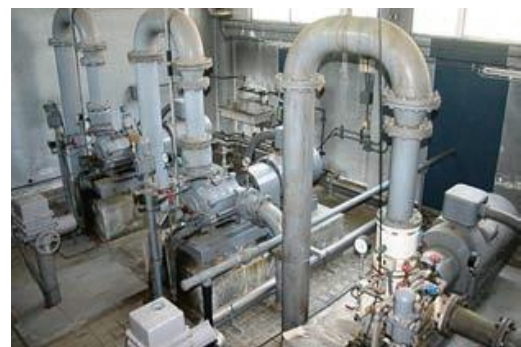
写真 2.7 佐古浄水場配水ポンプ
