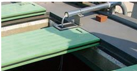
写真 2.3 着水井と塩素注入器
