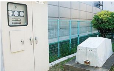
写真 2.2 取水井と取水ポンプ盤
