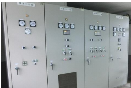
写真 2.8 佐古浄水場ポンプ制御盤
