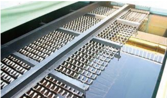
写真 2.4 傾斜板沈澱池
