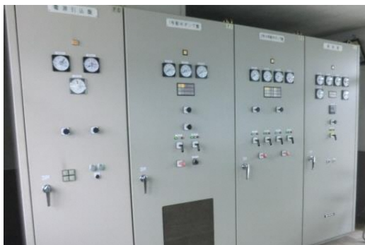
写真 2.8 佐古浄水場ポンプ制御盤
