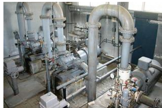
写真 2.7 佐古浄水場配水ポンプ
