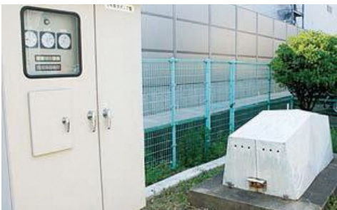
写真 2.2 取水井と取水ポンプ盤
